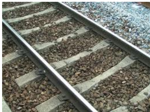
Figure 2 : Traverses béton d'une voie de chemin de fer
